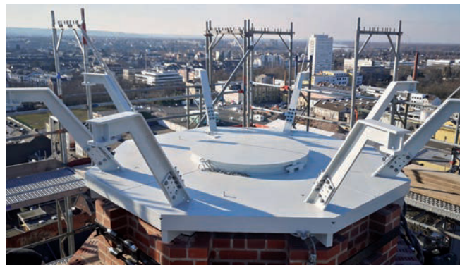
Mündungsabdeckung mit Einstieg und Aufnahme für die Wartungseinrichtung
